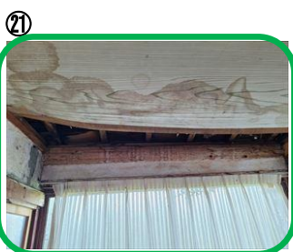
雨漏り箇所確認
