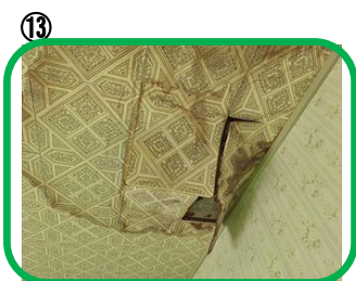
天井の剥がれを確認
