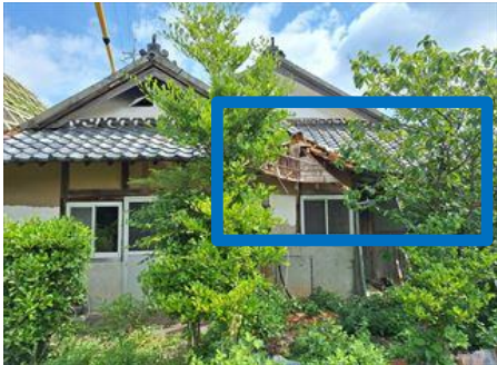
一部倒壊しています
