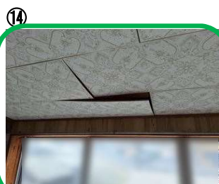
天井の剥がれを確認
