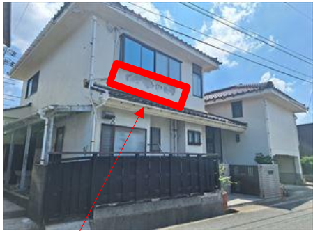
外壁塗装剥がれ有り
