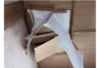
①天井落ち確認箇所
